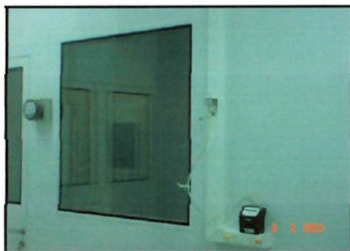
Fig. 4. Hall de entrada a sala de compressão
